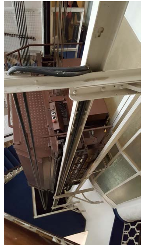
Fahrkorb von außen im Schacht
