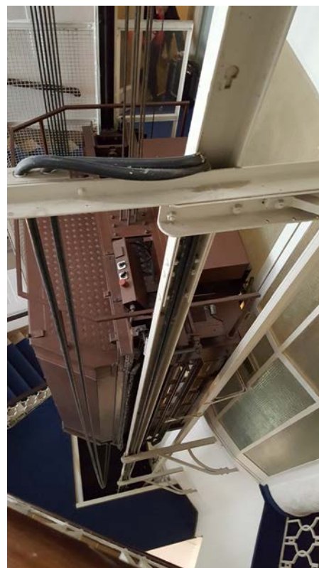
Fahrkorb von außen im Schacht
